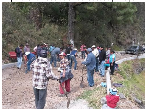
Imagen 23. Faena de los prestadores de servicios para la remodelación del acceso principal
